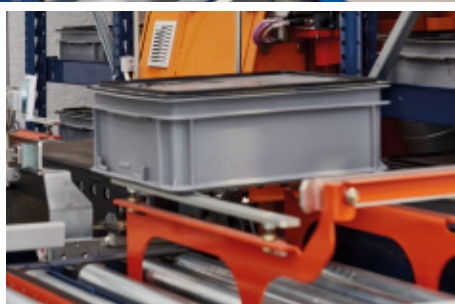
Zainstalowane w przedniej strefie magazynu miniload przenośniki rolkowe wyposażono w podnośnik, na który układnica odkłada lub pobiera pojemniki.
